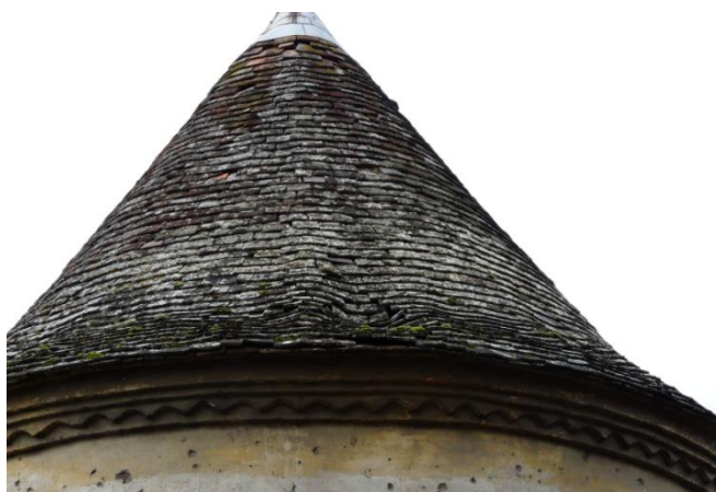
Document 19 : Détail de l'affaissement du toit du colombier de Varenne (Vue Est)
